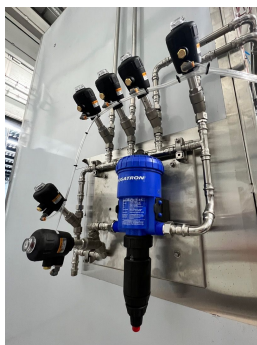
Все трубы изготовлены из нержавеющей стали
